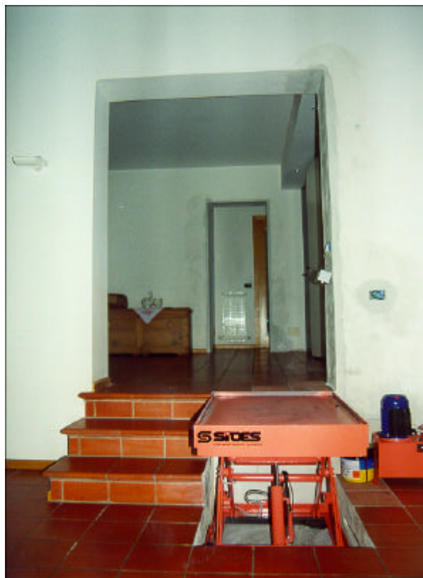
Foto n° 7 - Piattaforma elevatrice per superare il dislivello fra il piano terra e il piano rialzato.
