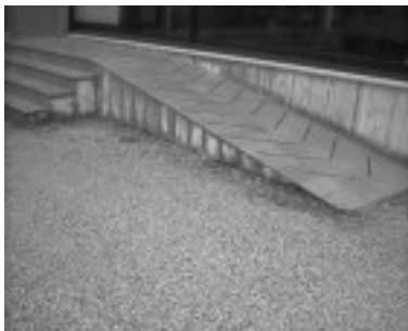
RAMPA PENDENZA ECCESSIVA
