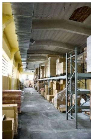
Fig.14.6 Tetto e pavimentazioni irregolari
